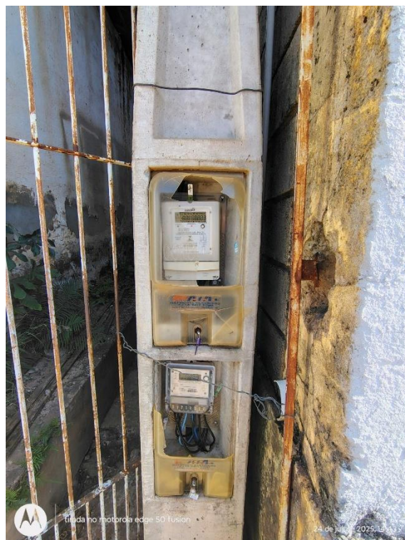
Imagem 4 – Quadro principal de energia elétrica
